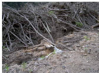
作業道より崩壊が始まる
